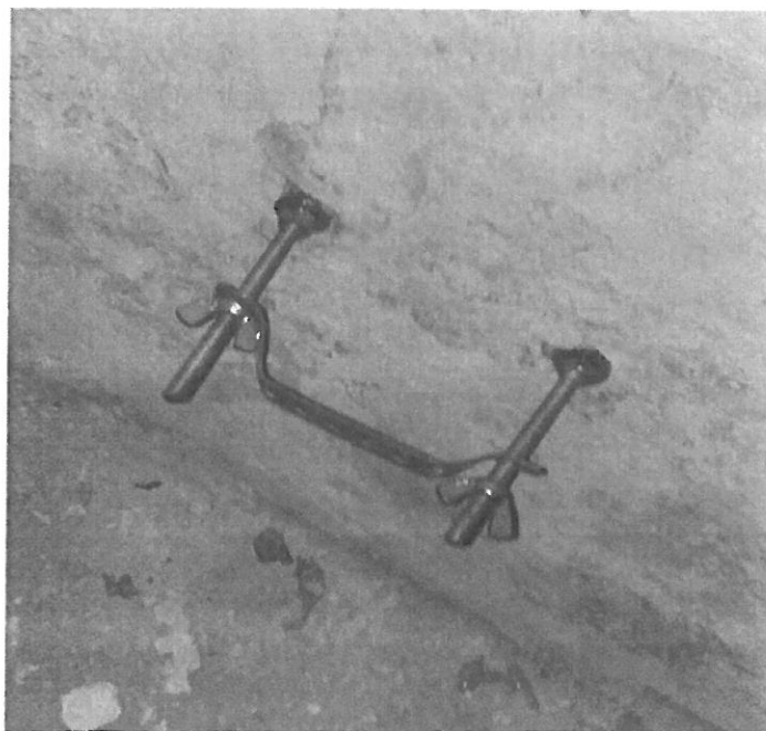
INSTALLAZIONE NON TERMINATA
